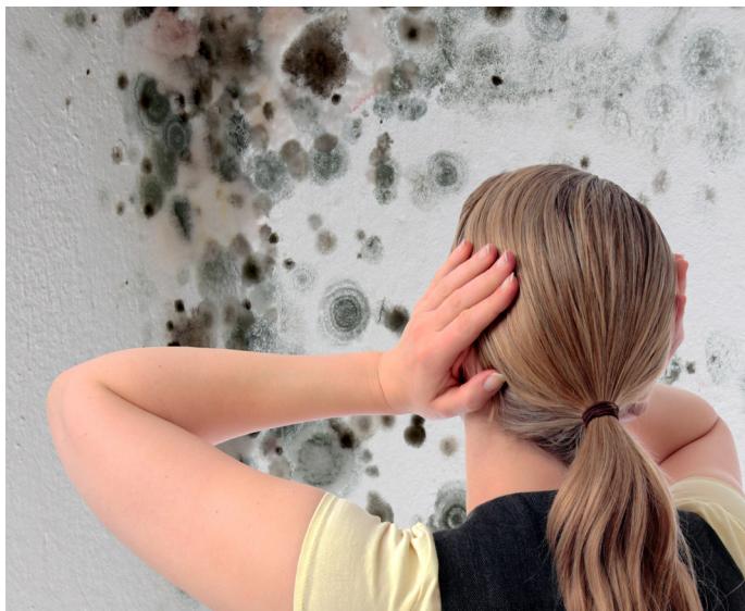
Lästige Plage in ungelüfteten oder falsch gelüfteten Kellern: Schimmel und Modergeruch entstehen, wenn feuchte Luft an kalten Wänden kondensiert.
