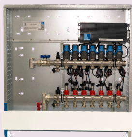
Heizkreisverteiler, Kaltwasserzähler & EGO-Regelantrieb für Fußbodenheizung
